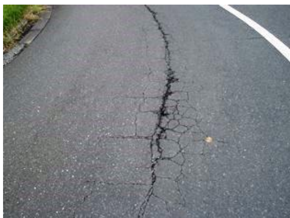
アスファルト舗装経年劣化 構-8
