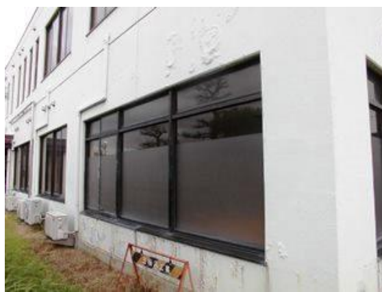
塗装の剥がれ 外-34 (浴室外側外壁)
