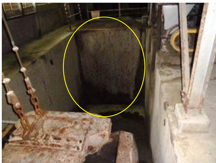
写真番号：内プー 1 8 1 階灰ピット 前回精密点検時に見られた側面コンクリート 欠落、鉄筋露出部は鉄板 補強により補修済
