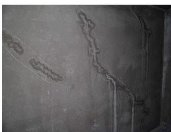
炉室内部漏水跡 内プ-49 (マーキングし経過観察中と思われる)
