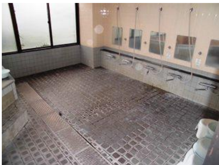
写真番号：内管－１８ １階浴室 外部に面するタイルの一部 に浮きあり
