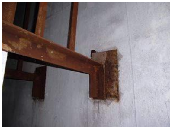
ラダー支持部錆 煙-6
