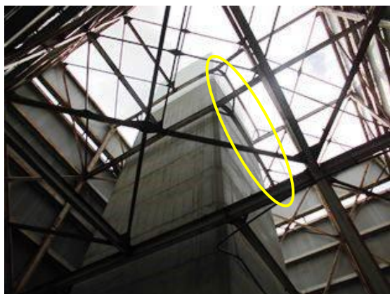
炉室上部鉄骨損傷 屋-12
