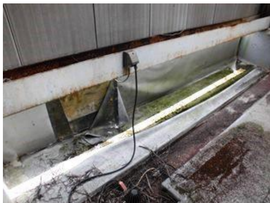
炉室屋根シート防水はがれ 屋-7
