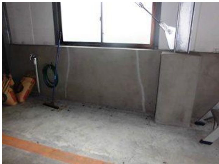
写真番号：付－ 3 助燃剤受入棟 内観 腰壁ひび割れ補修跡あり
