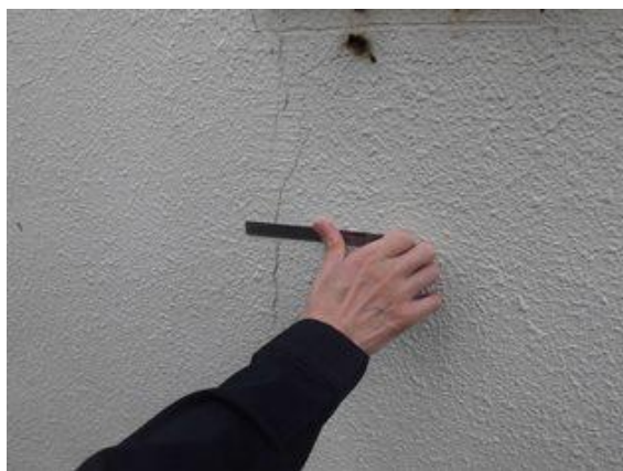
ひび割れ状況 外-8 ひび割れ幅 0.40mm
