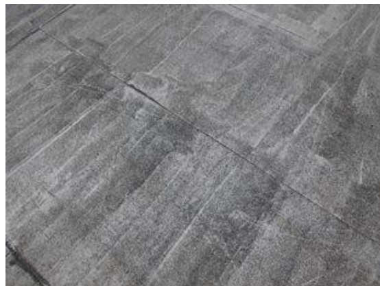
炉室上部浮き・表面にひび割れあり 屋-5
