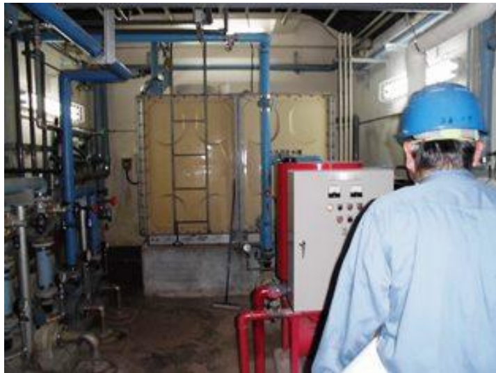
写真番号：内プー 1 4 1 階ポンプ室
