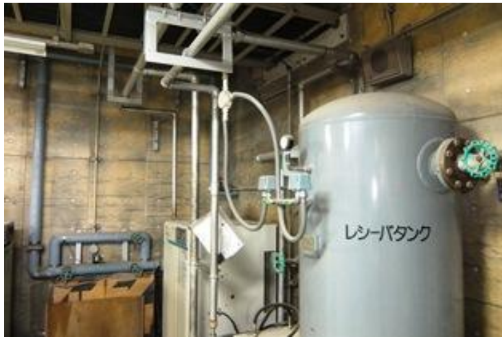
写真番号：内プー 1 3 1 階油圧ユニット室
