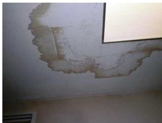
2 F 廊下西側トップライト部漏水跡 内管-2 2
