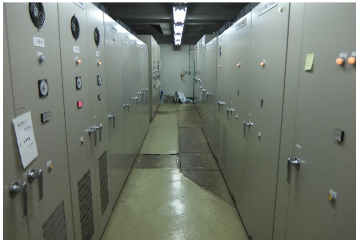
写真番号：内プー 2 3 2階動力制御室
