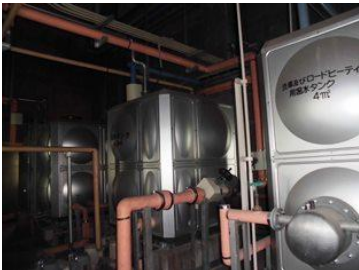
写真番号：内プー 2 4 3階温水タンク室
