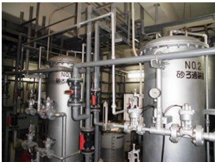
写真番号：内プー 1 1 1 階排水処理室
