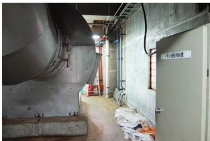
写真番号：内プー 1 7 1 階誘引通風機室
