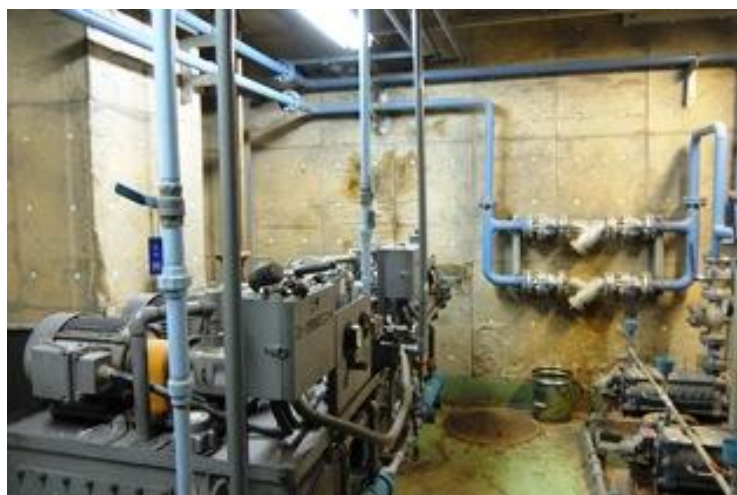
写真番号：内プー 1 2 1 階油圧ユニット室
