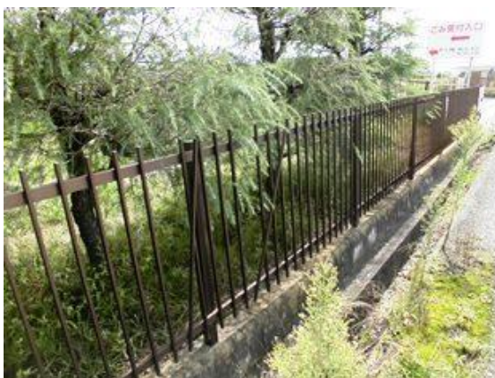
フェンス縦格子のはずれ 構-1 5
