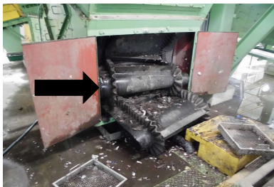
焼損・脱落したベルト
